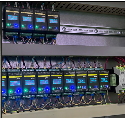
Монтаж контроллеров А636 в САУ ГПА МСКУ – СС4510
